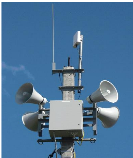
Рис. 11.4 УЗС Блок коммутации и управления.
